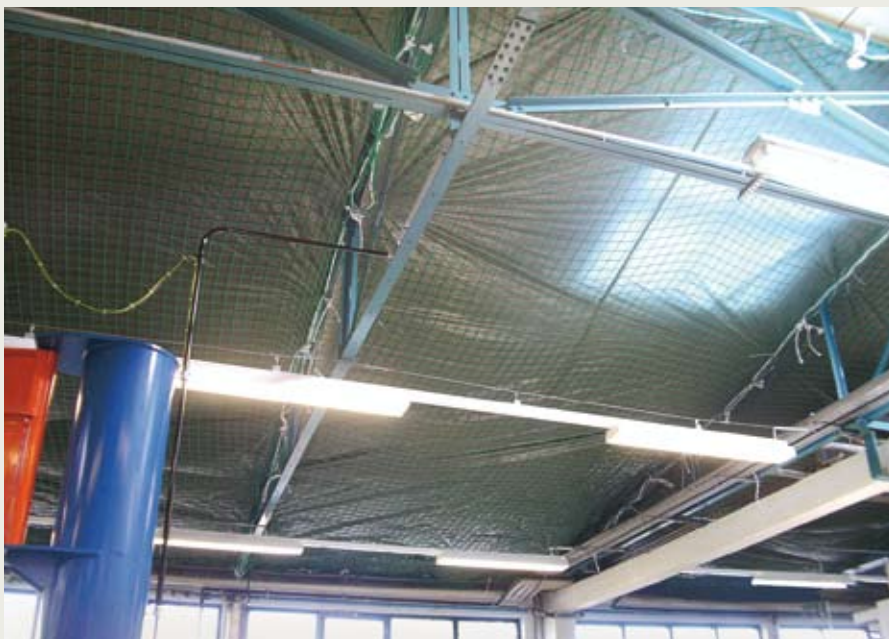
Umfangreiche Baustellenvorbereitungen vor Beginn der Sanierung: Im Innenbereich der Industriehalle wurden unter anderem Personenfangnetze und Staubschutz-Folien gespannt.
